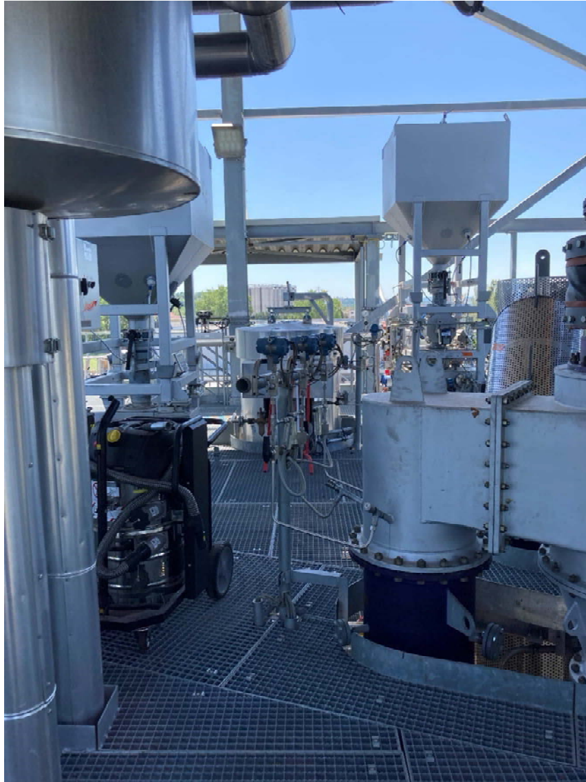
Figure 4 : vue de l'avant-dernier étage de la plateforme où les travaux de modification de la ligne de traitement des fumées et de la ligne syngaz seront réalisés
